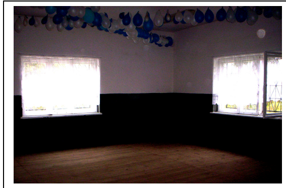
Sala wymagająca modernizacji
