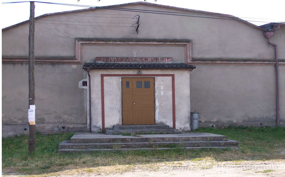
Fot. Świetlica na działce nr 57, tzw. sala taneczna. Obiekt wymagający remontu.
