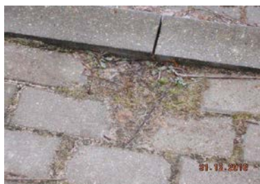
zaniżenie względem krawężnika, obrzeża poniżej 0,0 cm
