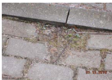
zaniżenie względem krawężnika, obrzeża poniżej 0,0 cm
