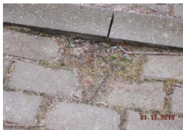
zaniżenie względem krawężnika , obrzeża poniżej 0,0 cm
