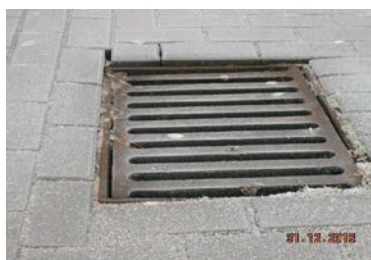
Kratki ściekowe , pokrywy włazów zaniżenie lub zawyżenie względem nawierzchni o 0,5 cm do regulacji
