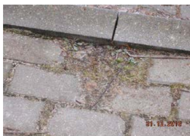
zaniżenie względem krawężnika , obrzeża poniżej 0,0 cm
