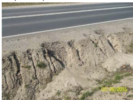
rozmycia do uzupełnienia
