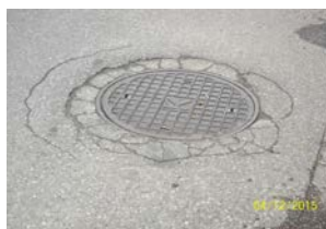
spękanie wokół studni
