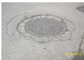
spękanie wokół studni
