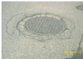
spękanie wokół studni
