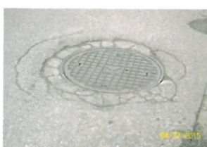
spękanie wokół studni
