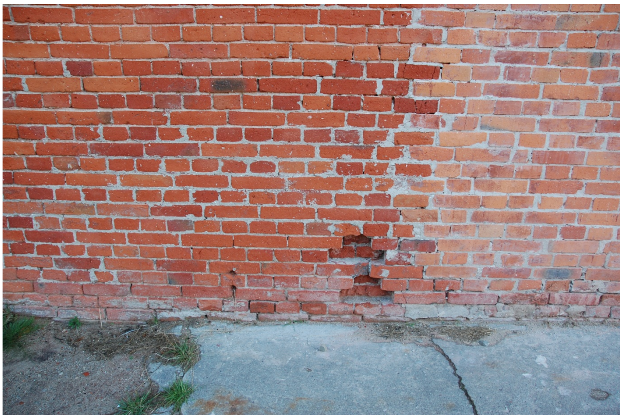
Fot. 7 Elewacja zachodnia. Widoczne zamurowanie otworu drzwiowego i uszkodzone lico cegły w strefie cokołowej.
