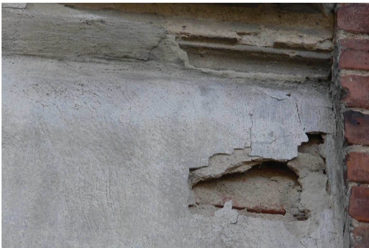
Fot. 12 Elewacja wschodnia. Fragment blendy pokrytej odpajającą się wtórną zaprawą cementową.
