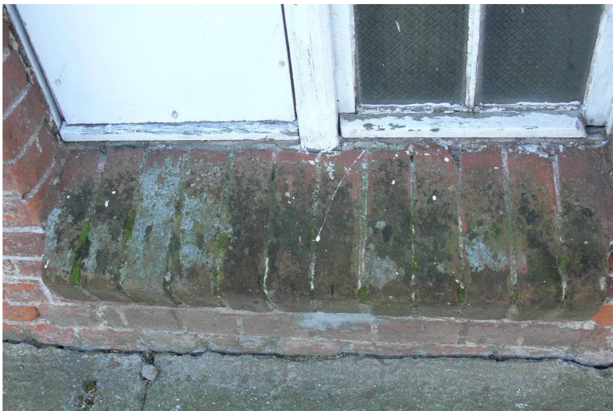
Fot. 10 Elewacja północna. Parapet okna suterenu z widocznymi wykwitami mchów i porostów.
