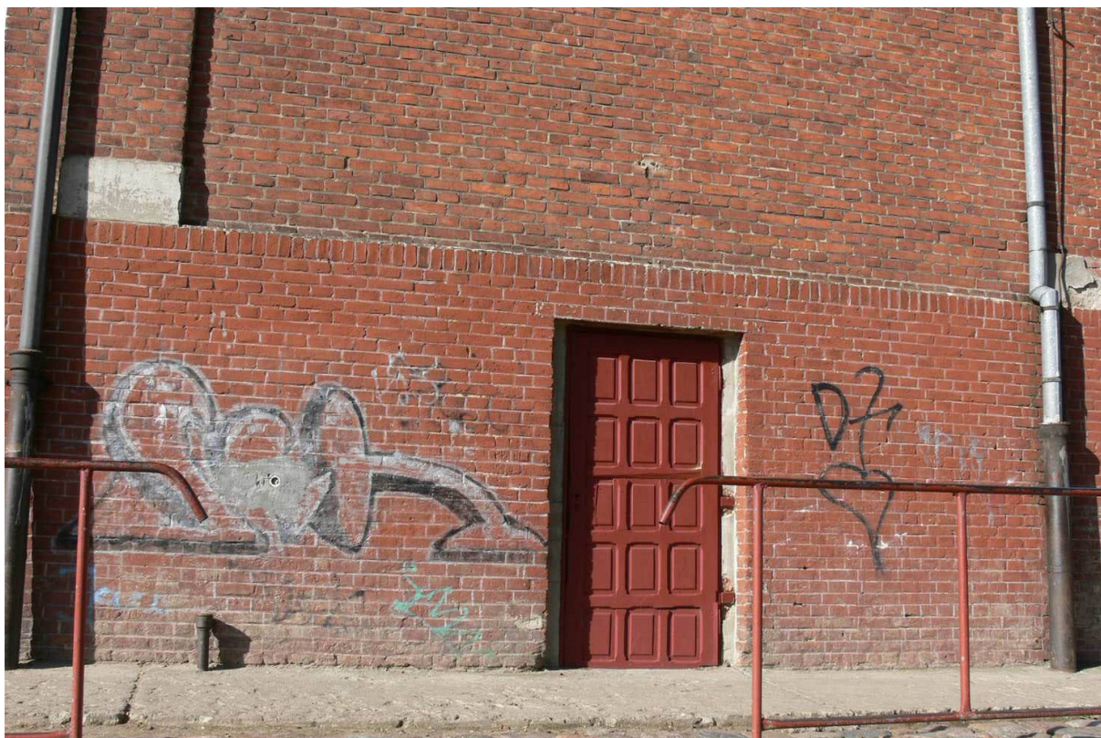
Fot. 5 Elewacja wschodnia. Widoczna zamalowana farbą strefa cokołowa i wtórna stolarka drzwiowa.
