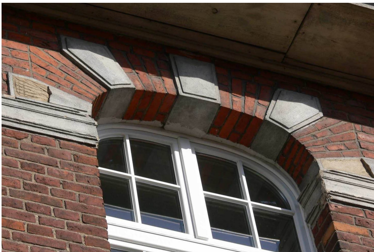
Fot. 6 Elewacja zachodnia. Fragment uszkodzonej dekoracji architektonicznej wokół otworów okiennych.
