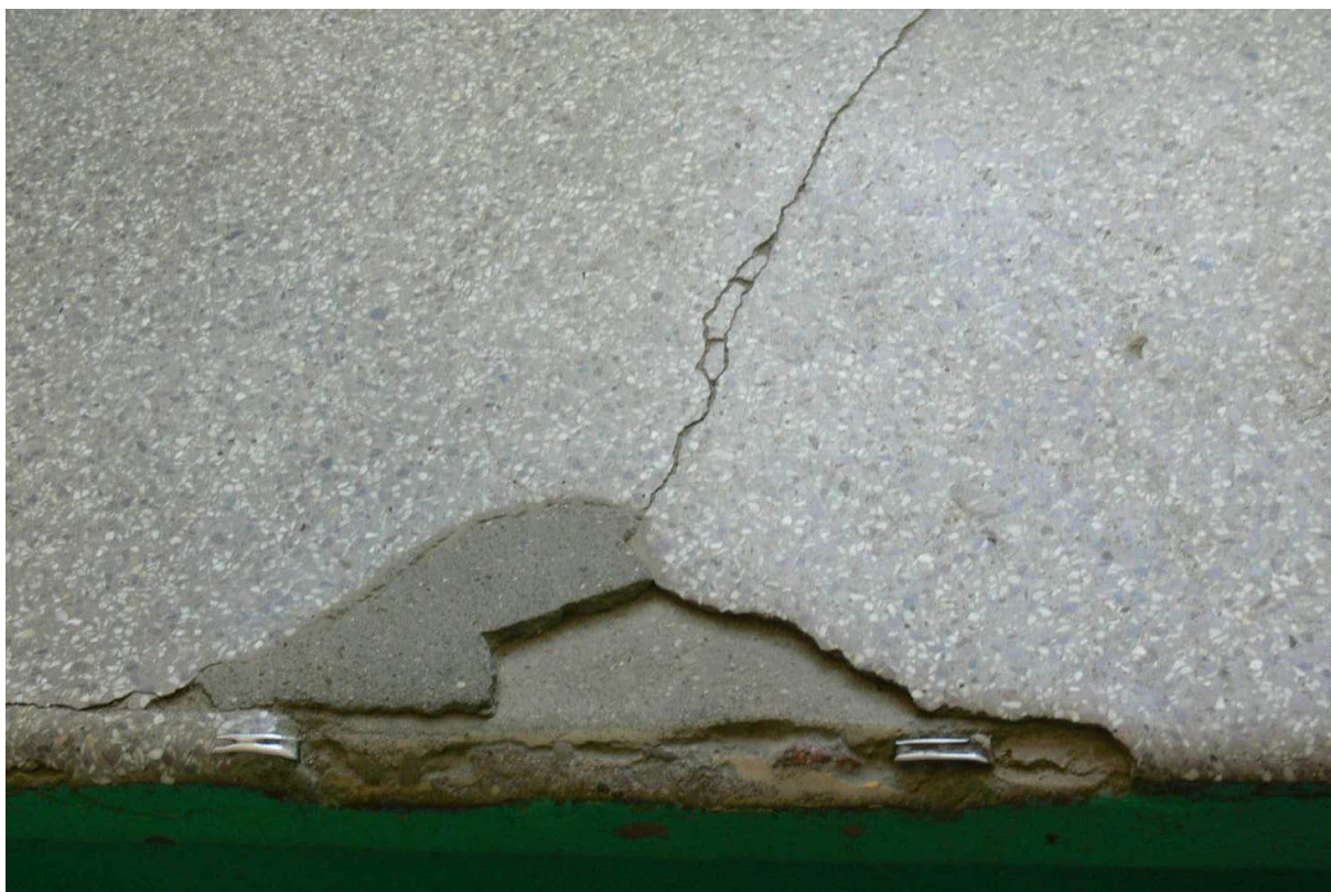
Fot. 24 Główna klatka schodowa. Fragment stopni z widocznym uszkodzeniem wtórnego lastrykiem.
