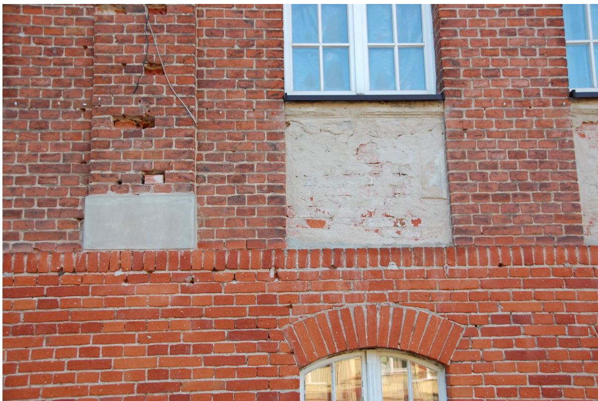
Fot. 11 Elewacja zachodnia. Fragment z widoczną uszkodzoną strefą cokołową oraz ubytkami oryginalnego tynku w blendach.
