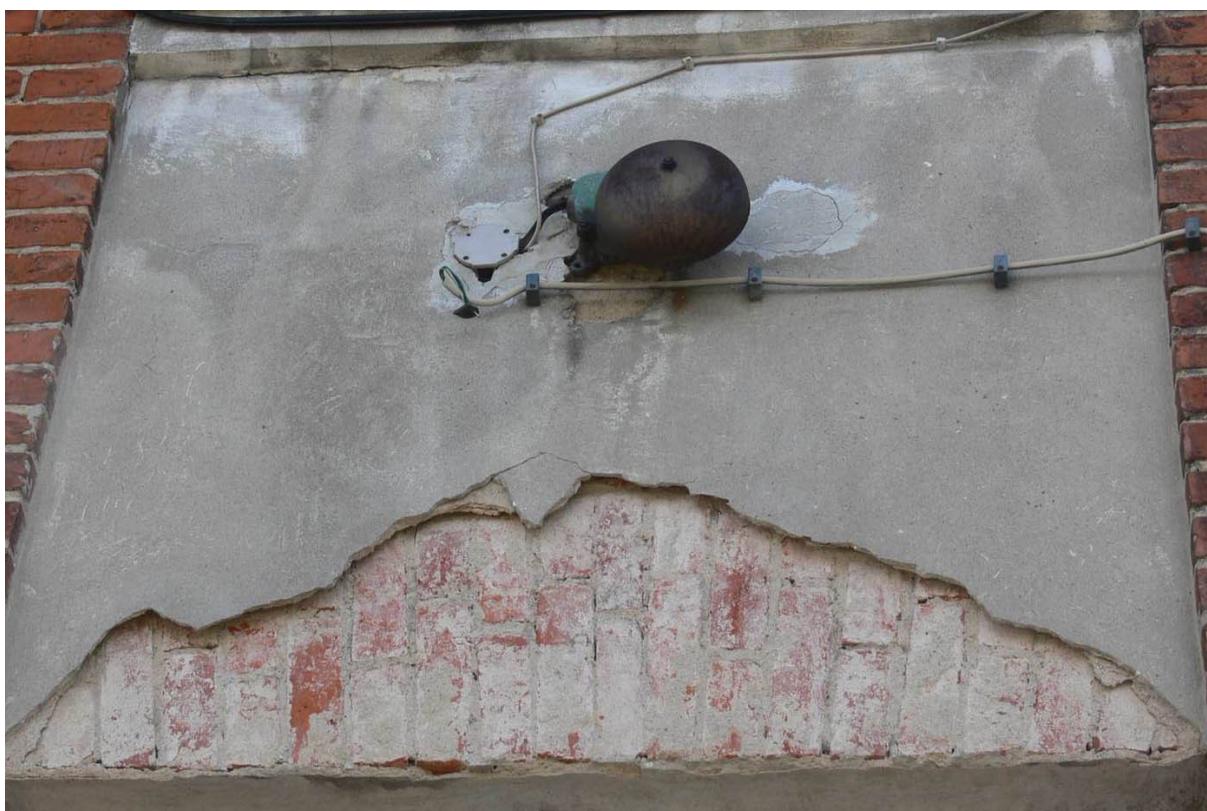
Fot. 20 Elewacja zachodnia. Wtórny dzwonek z instalacją elektryczną prowadzoną prowizorycznie po elewacji.
