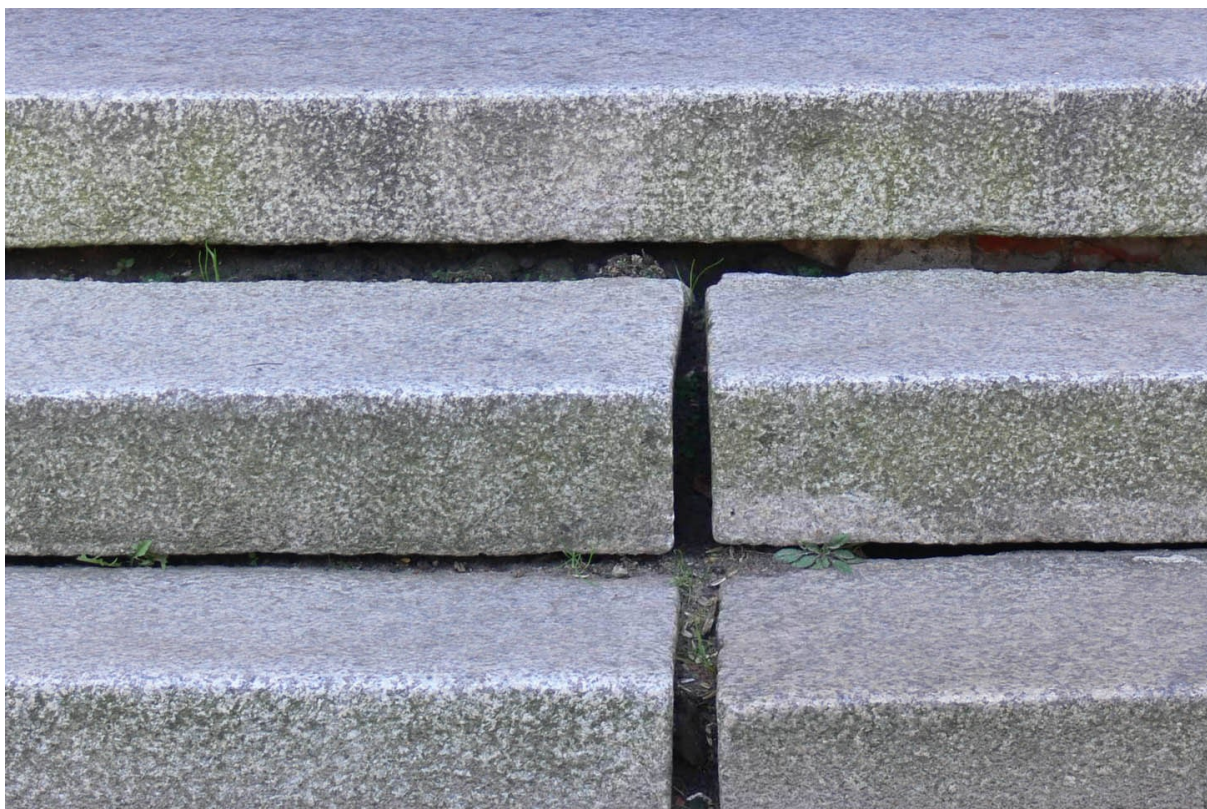
Fot.18 Wejście główne. Schody granitowe z widocznym osunięciem bloków kamienia.
